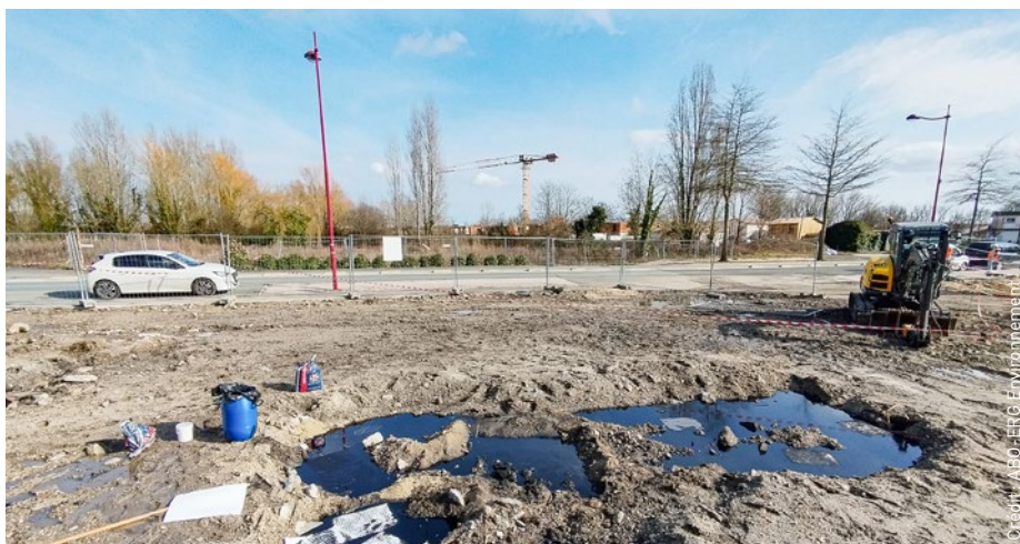
Photo 5 : Sols et liquides souillés découverts en terrassement : tri, filières et traçabilité doivent être organisés sans délai.
