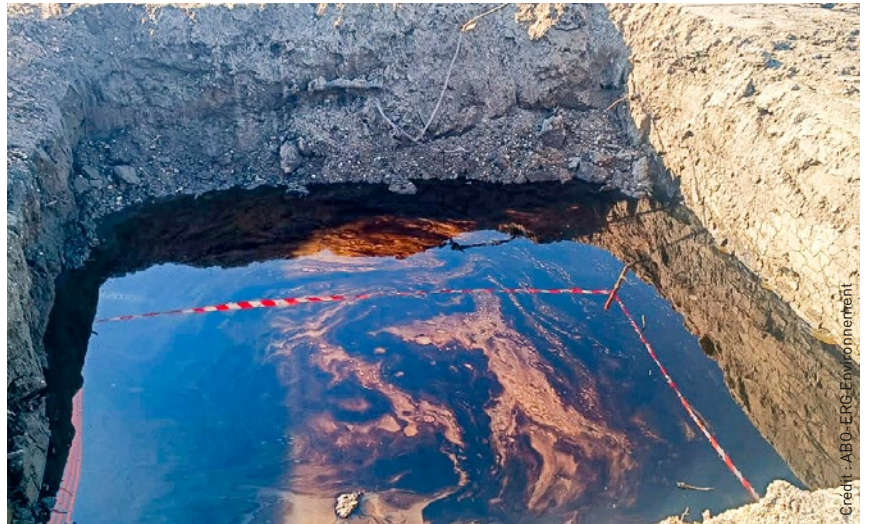
Photo 3 : Eaux ou produits hydrocarburés mis au jour en fond de fouille : un aléa de terrassement à caractériser et sécuriser rapidement.
