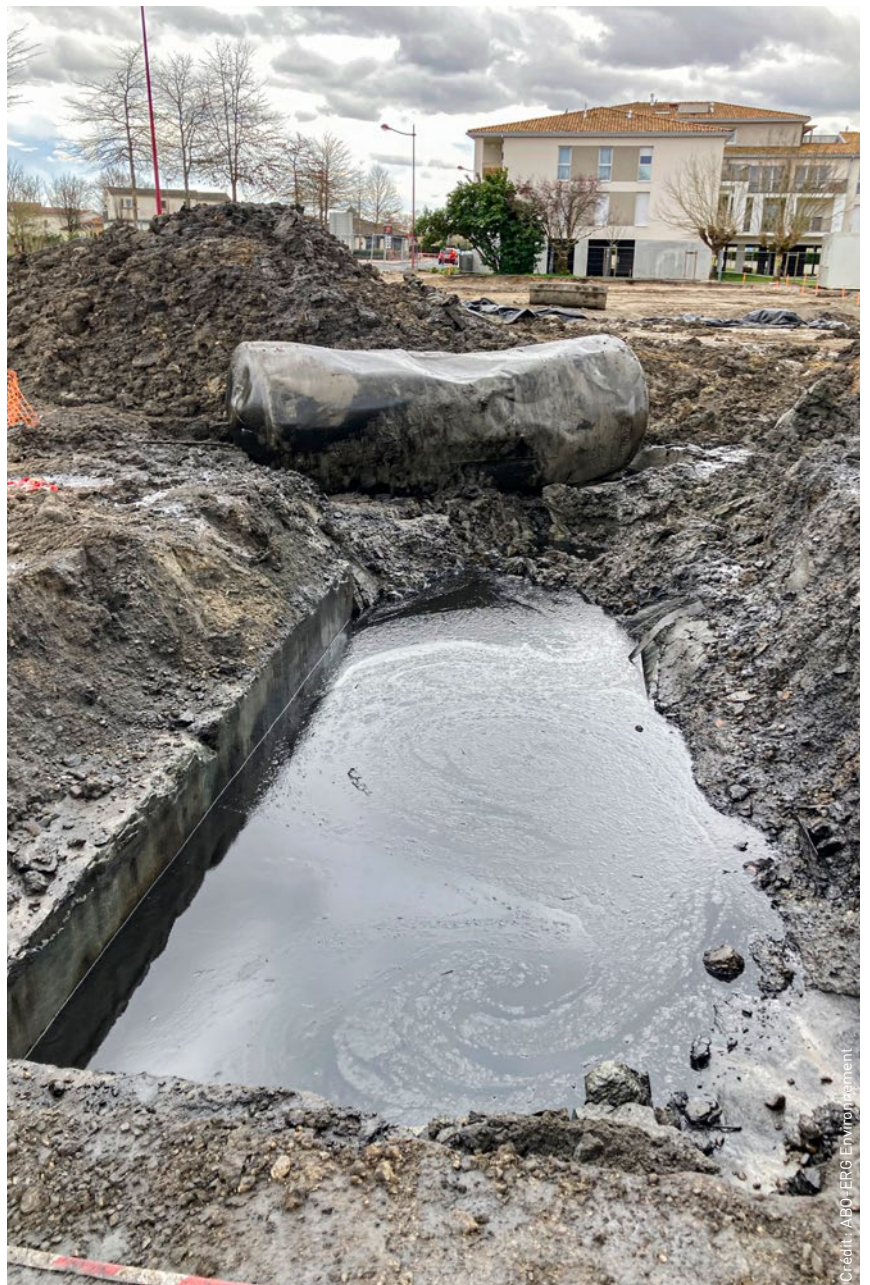
Photo 4 : Ouvrage associé à une ancienne cuve et présence de liquides fortement impactés : un constat nécessitant l'adaptation immédiate du chantier.
