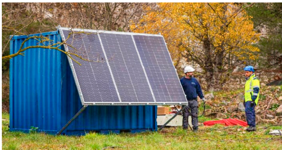
Figure 4 - Unité de traitement solaire connectée pour pompage / traitement d'effluents
