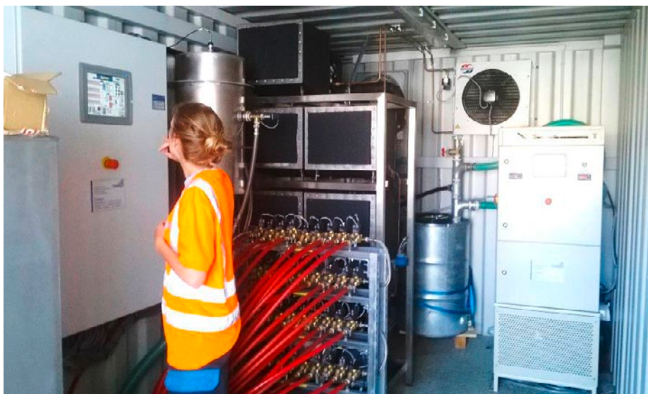
Figure 3 - Armoire de régulation de chauffage pour désorption thermique avec automate de télégestion
