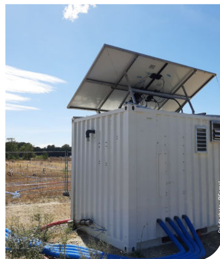
Process de dépollution in-situ à énergie solaire
