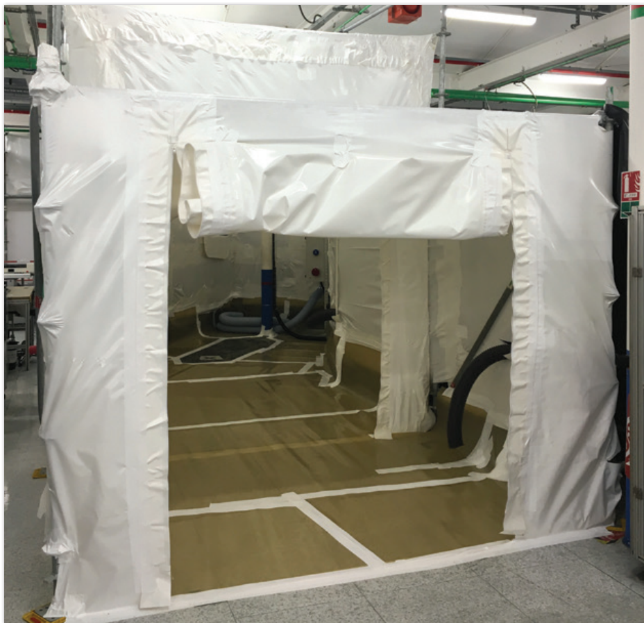
Vue d'une des trois zones de confinement
