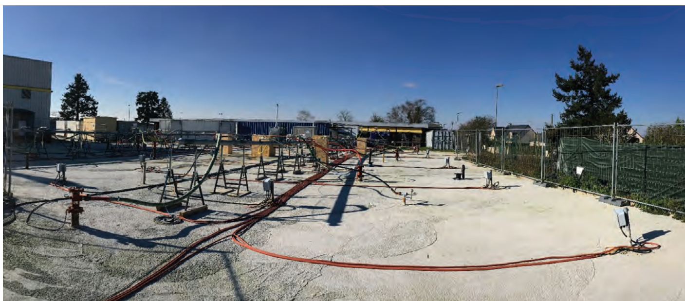
Figure 4 : Vue de l'installation de traitement par ERH.
