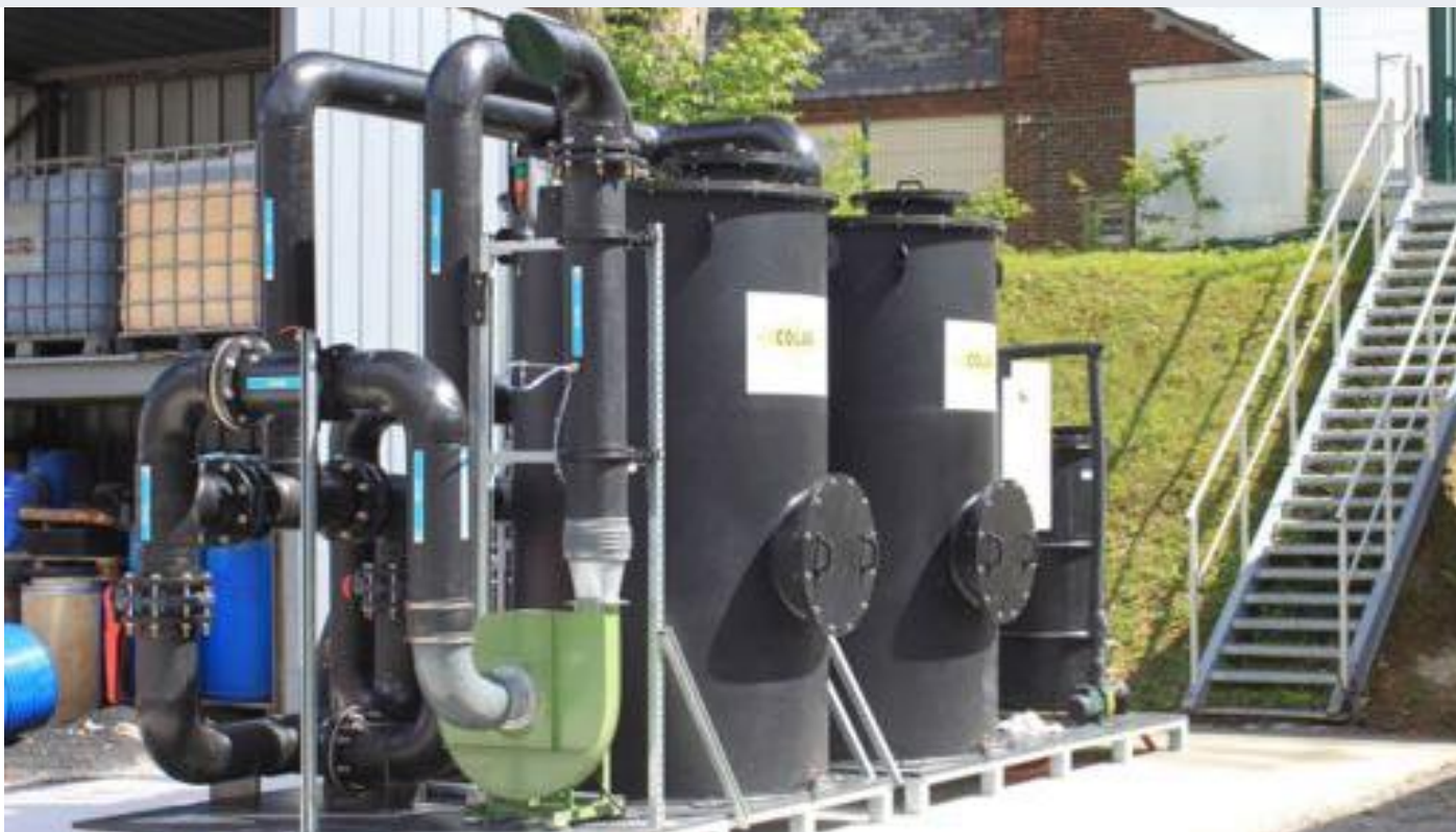
Skid de traitement des effluents gazeux
