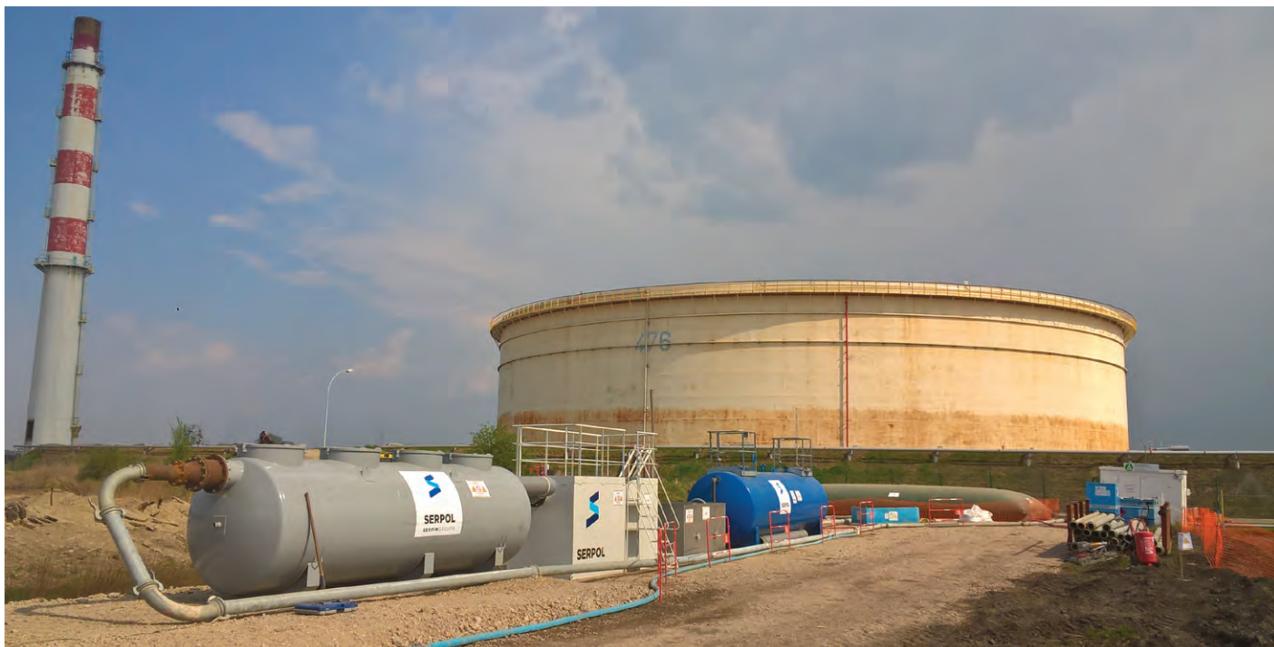
Unité de pré-traitement des eaux
