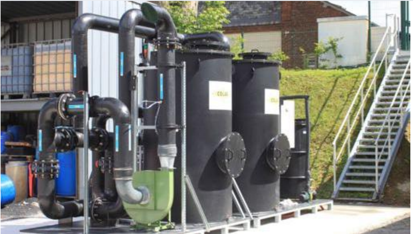
Skid de traitement des effluents gazeux
