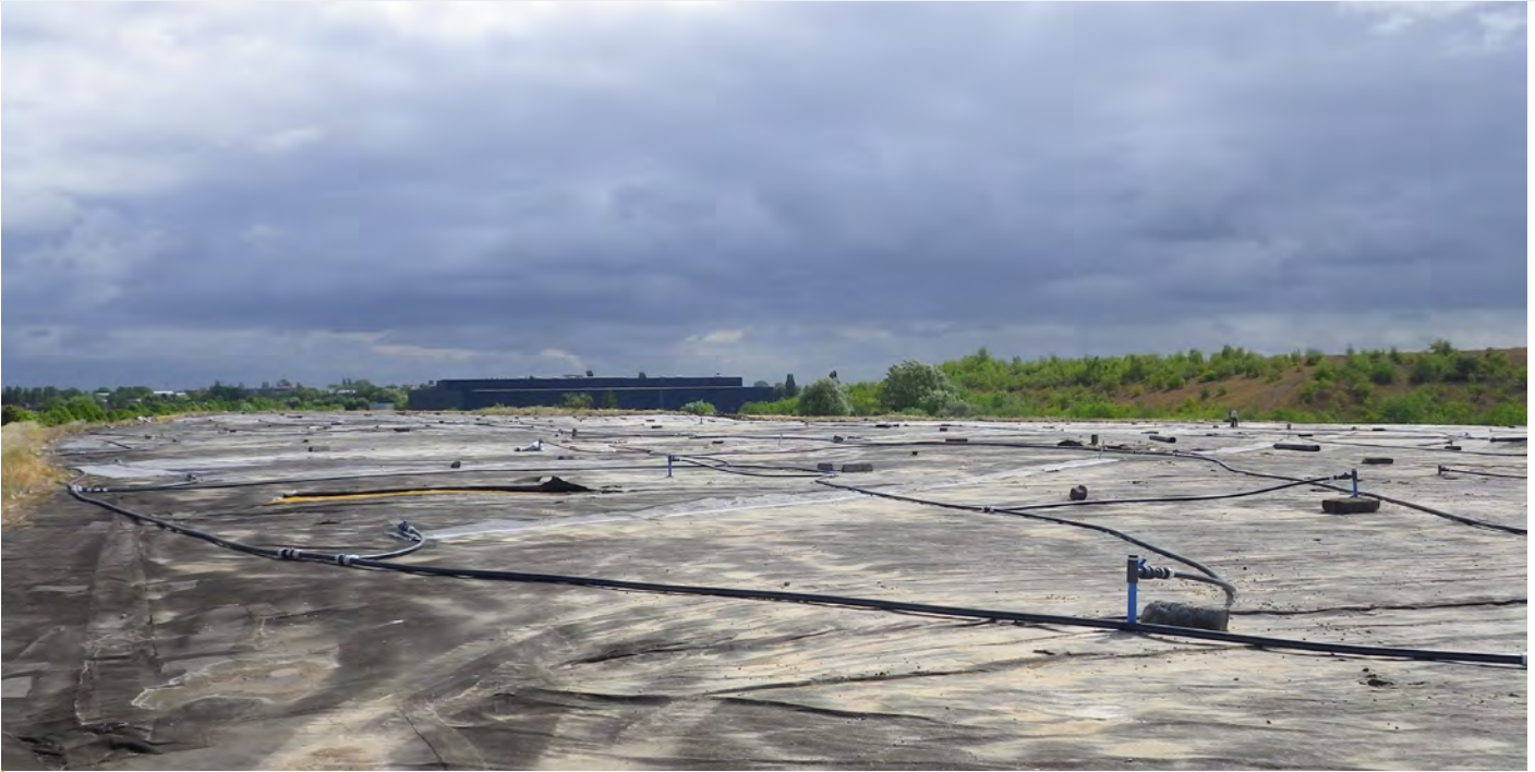
Figure 3 : réseau d'injection au toit du terril.
